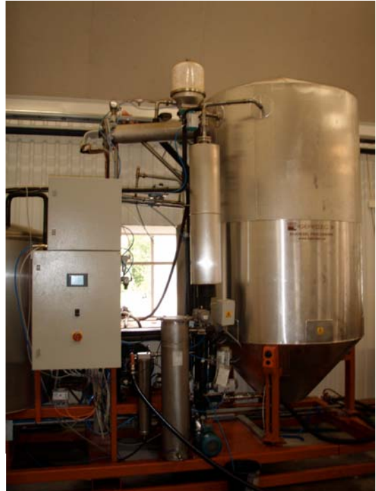
Per Norrbys RME-fabrik.
